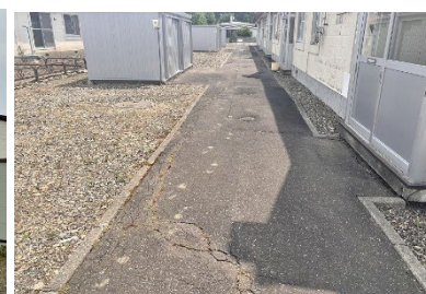
団地内通路の劣化: さくら団地
